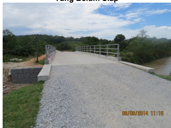
Gambar 3.8 Kerja Penurapan Jalan Yang Belum Siap
